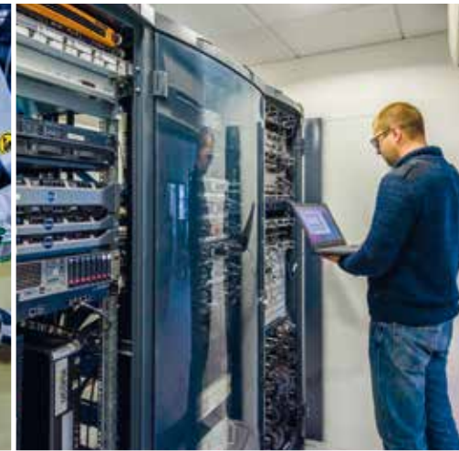
> Dépannage data center et salle informatique
